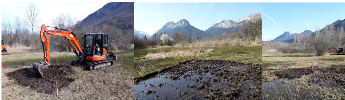
Travaux d'étrépage et bouchage de drains en mars 2021 (à g. et milieu : secteur Chenevières, à d. : secteur Pré Poisson)
